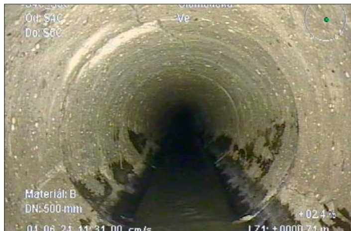
Bezvýkopová oprava kanalizace - stav před opravou...
